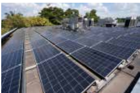
Zonne-installatie van 671 m 2 op het dak van het commerciële gebouw « Petit Pont » (zakendistrict), met een gemiddelde productie van ongeveer 380 kWh per dag.
