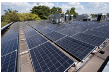
Installation solaire de 671 m 2 sur la toiture du bâtiment commercial "Petit Pont" (quartier des affaires), avec une production moyenne d'environ 380 kWh/jour.
